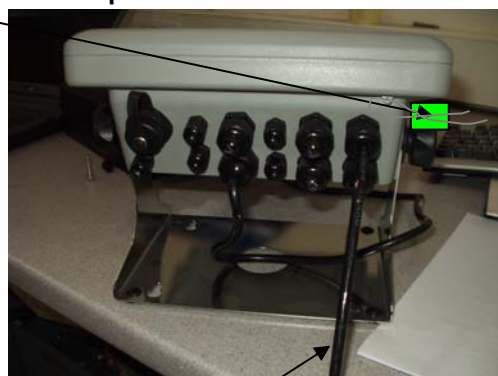
Spoj kablova MPS u kućištu EPU
